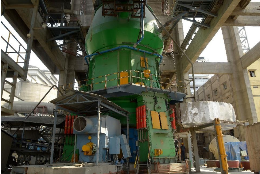
Imagen superior: Molino LOESCHE ya en operación para Ramco Cements Limited en Ariyalur, India
