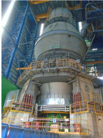
采用 COPE 新驱动的莱歇磨机 LM 70.4+4 CS 在 Mfamosing 水泥厂成功运行
