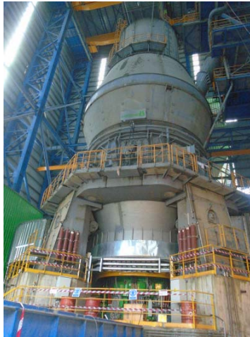
El molino LOESCHE tipo LM 70.4+4 CS en funcionamiento con el nuevo accionamiento COPE en la fábrica de cemento Mfamosing.
