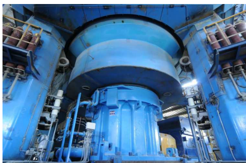
在印尼 Banyuwangi 水泥厂运转的莱歇磨机的减速机
