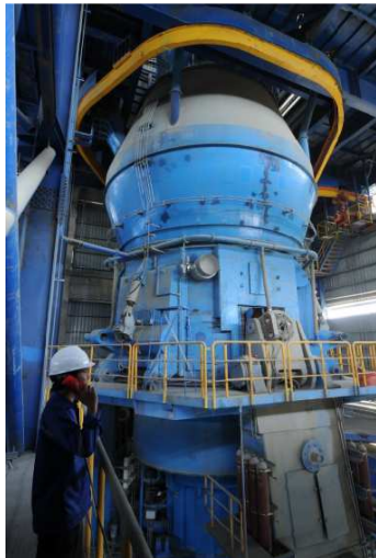
Gracias al perfecto funcionamiento del molino de cemento LOESCHE, el equipo profesional de la fábrica de cemento de Banyuwangi (Indonesia) puede trabajar sin interrupciones.
