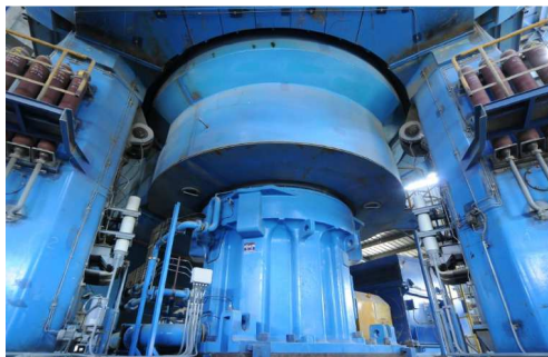
Reductores del molino LOESCHE operativo en la fábrica de cemento de Banyuwangi, Indonesia
