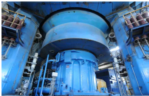
Das Getriebe der LOESCHE Mühle in Betrieb im Zementwerk Banyuwangi, Indonesien
