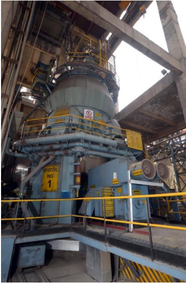
Eine Loesche-Mühle des Typs LM 43.4 D zur Vermahlung von Petrolkoks in Kotputli, Indien.
